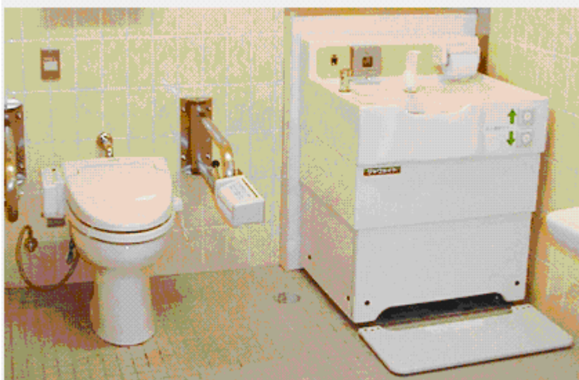
【市立病院リハビリテーション棟1階に設置されたオストメイト用トイレ】
