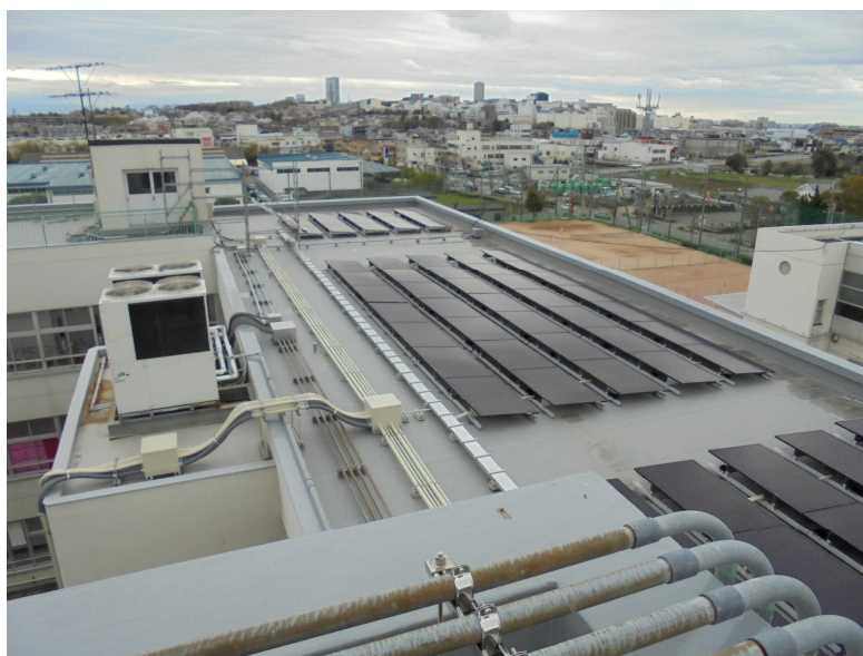
〈第四中学校 太陽光発電設備〉
