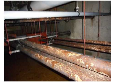
電気幹線配管 電線管腐食 (漏電による全館停電の危険性)
