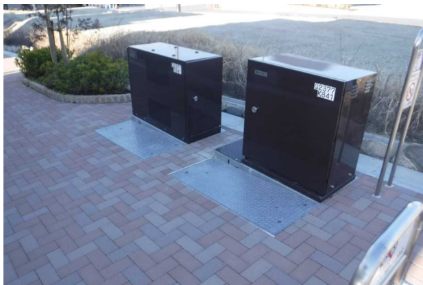
地上機器の設置例
