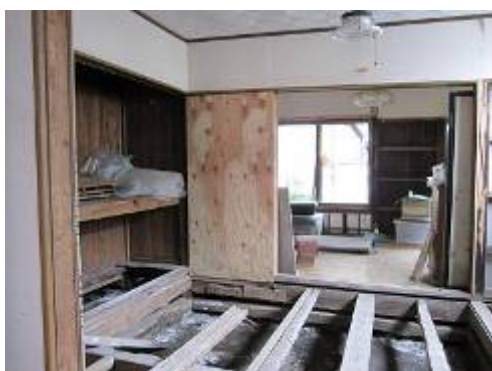
工事未定。1階部分は被災したまま、2階で暮らしている
