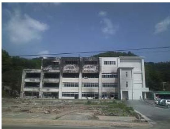
(写真⑧) 大槌小学校 1階を完全に飲みこんだ津波と、火災により被災 現在、一部が仮設庁舎として使用されている。
