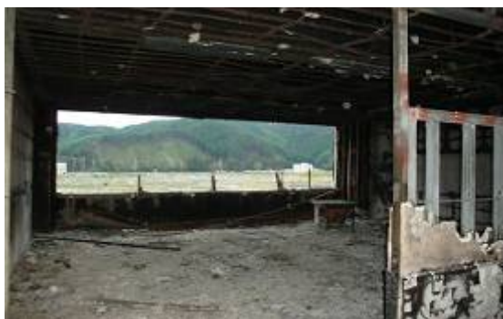
(写真⑪) 大槌小学校 火災の発生した教室
