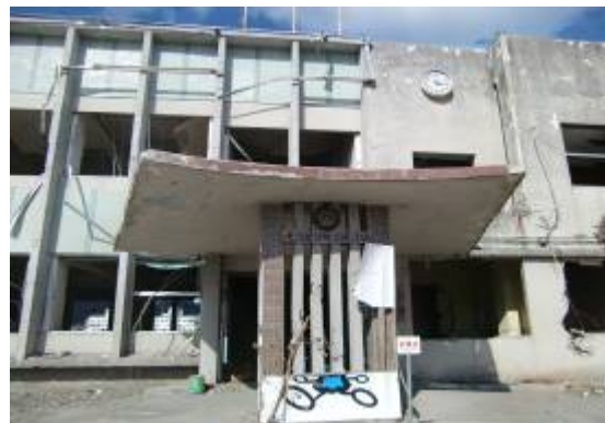
被災した大槌町役場
