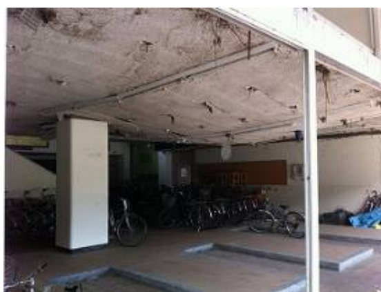
(写真⑨) 大槌北小学校 津波により被災した校舎には支援物資の自転車が 保管されている。
