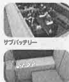
尿素タンクポンプケース
