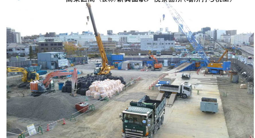
D バス乗降車箇所 高架区間・(仮称)新箕面駅／視察箇所(場所打ち杭工)
