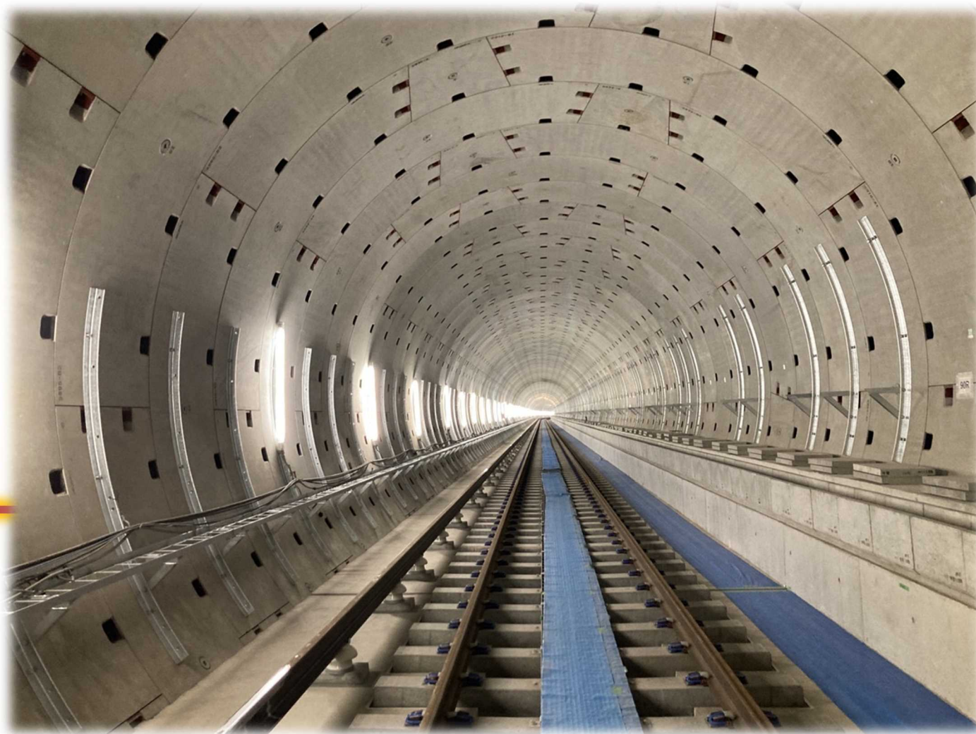
● 箕面船場阪大前駅～換気所間
