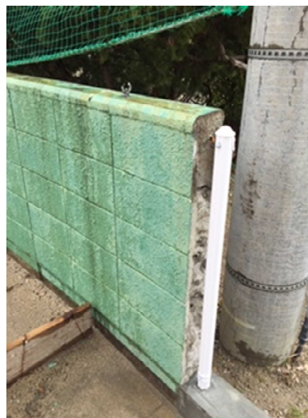
市民野球場 ブロック塀端部フェンス支柱
