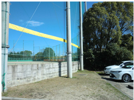
市民野球場 既設ブロック塀
