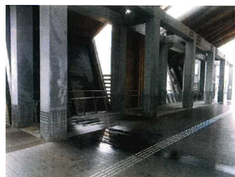
雨漏りの状況
