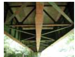
【 腐食】の例：かしの木谷橋
