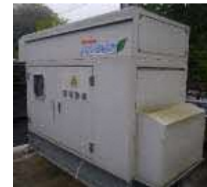
非常用発電機
