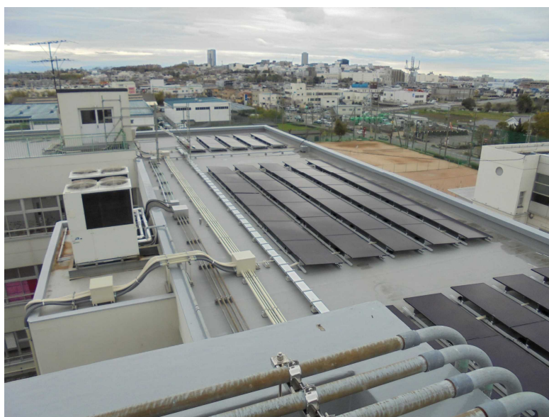
〈第四中学校 太陽光発電設備〉
